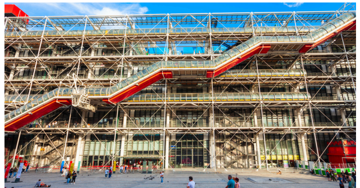
Participer à la réhabilitation du Centre Pompidou / Programmation et sélection MOE - CNAC
